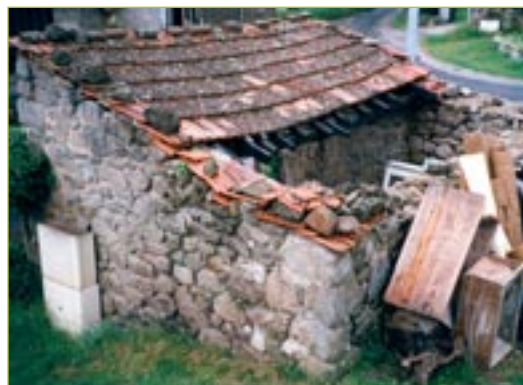
Le Lavoir de Praisles à Monistrol sera prochainement rénové
